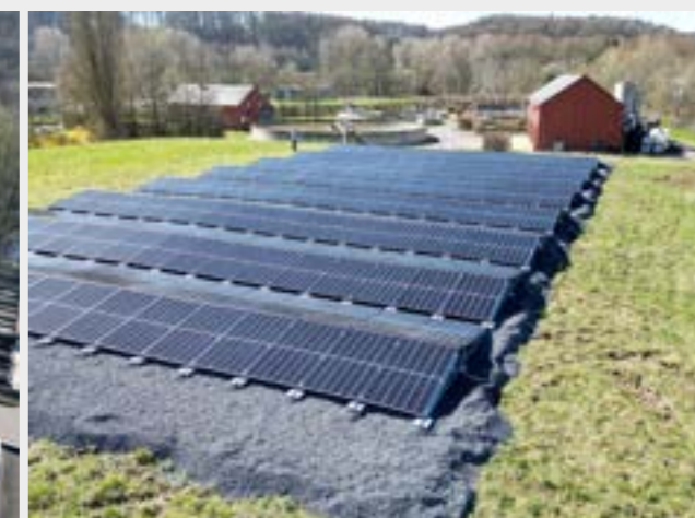
Station d'épuration de Grez-Doiceau
