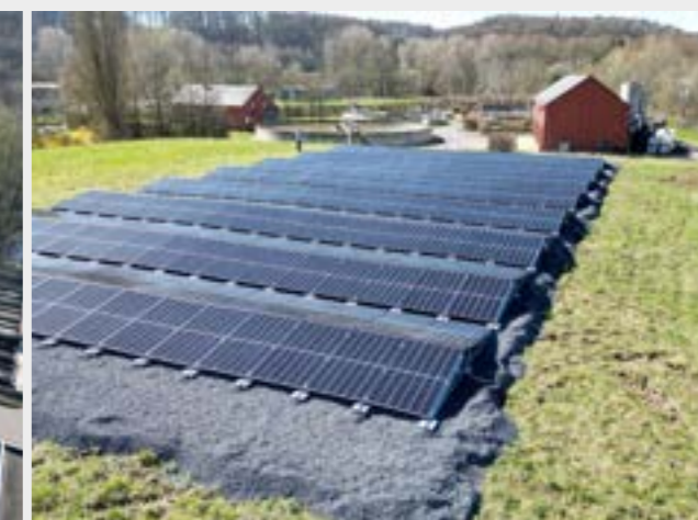
Station d'épuration de Grez-Doiceau
