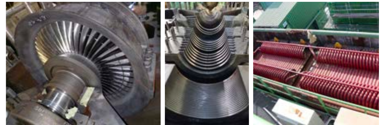
Nouveaux blocs économiseurs ligne 2
